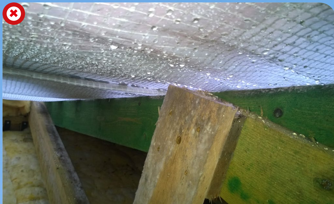
Kondenzace vzdušné vlhkosti na obyčejné nekontaktní pojistné hydroizolaci – transport vlhkosti přes fólii probíhá pouze pomocí konvekce.
