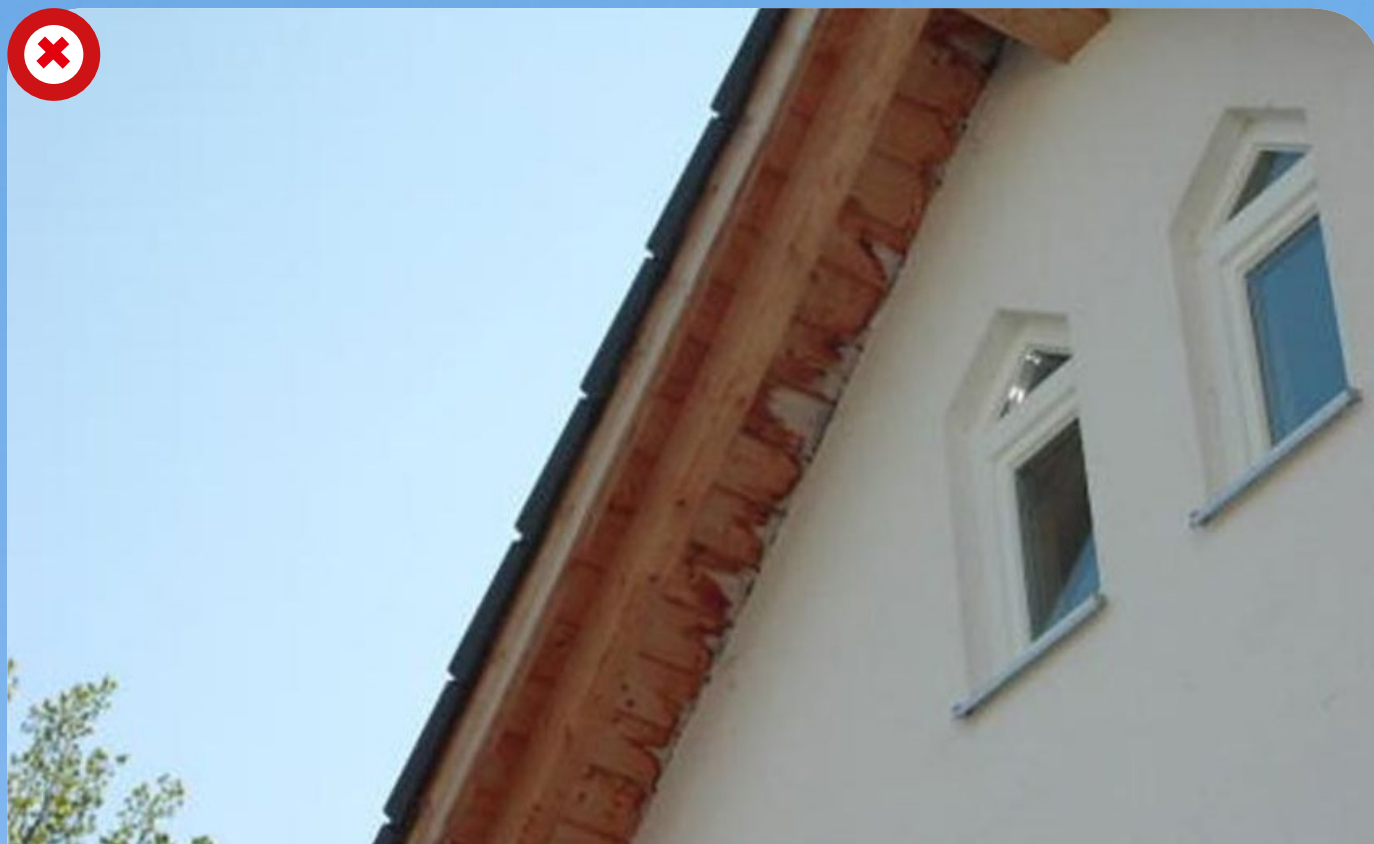
Námraza z pronikající vlhkosti do exteriéru vlivem nedokonale zajištěné vzduchotěsnosti
