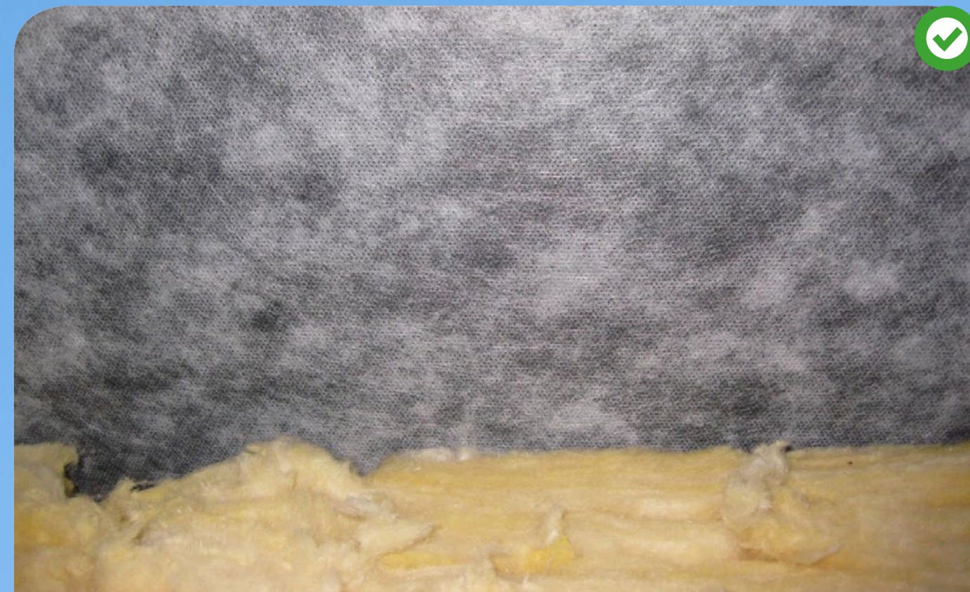
Nulový výskyt kondenzátu na kontaktní pojistné hydroizolační fólii Solitex (tmavší fólie) za stejných podmínek na stejné konstrukci – detail při přiblížení.
