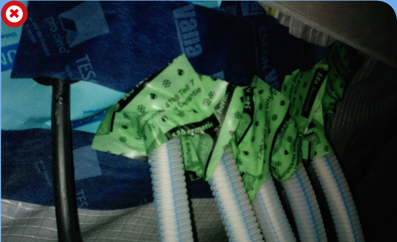
Nesystémové zajištění vzduchotěsnosti prostupu kabelů parobrzdou
