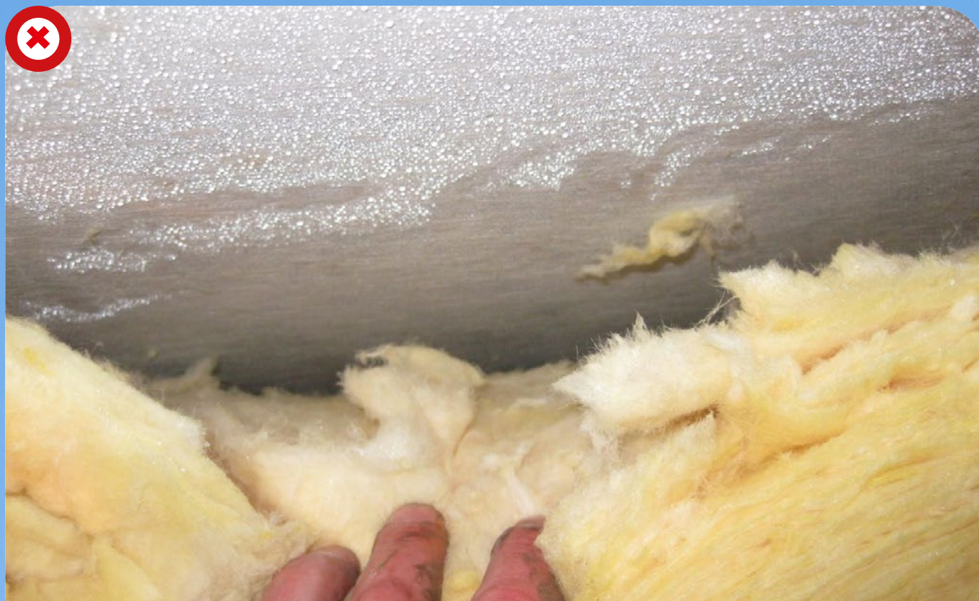
Kondenzace vzdušné vlhkosti na nekvalitní pojistné hydroizolaci při zvýšené vlhkové zátěži – zvětšení detailu (shodný objekt).
